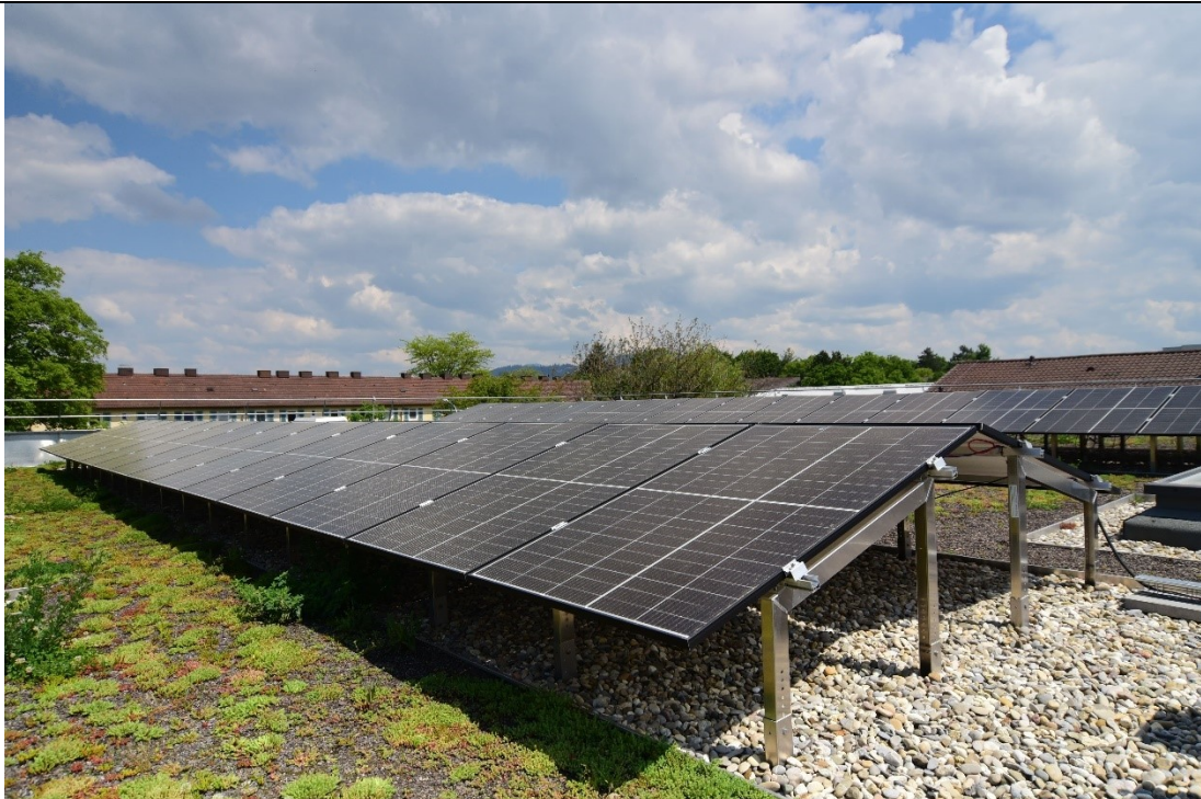
Abb. 7: PV-Anlage Kita Belchenstr.
