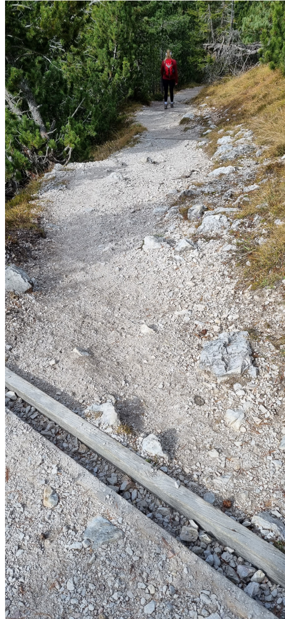
Abb. 137: Beispiel aus den Alpen: in kurzen Abständen eingebaute Wasserrinnen leiten den Hangabfluss ins Gelände [1]
