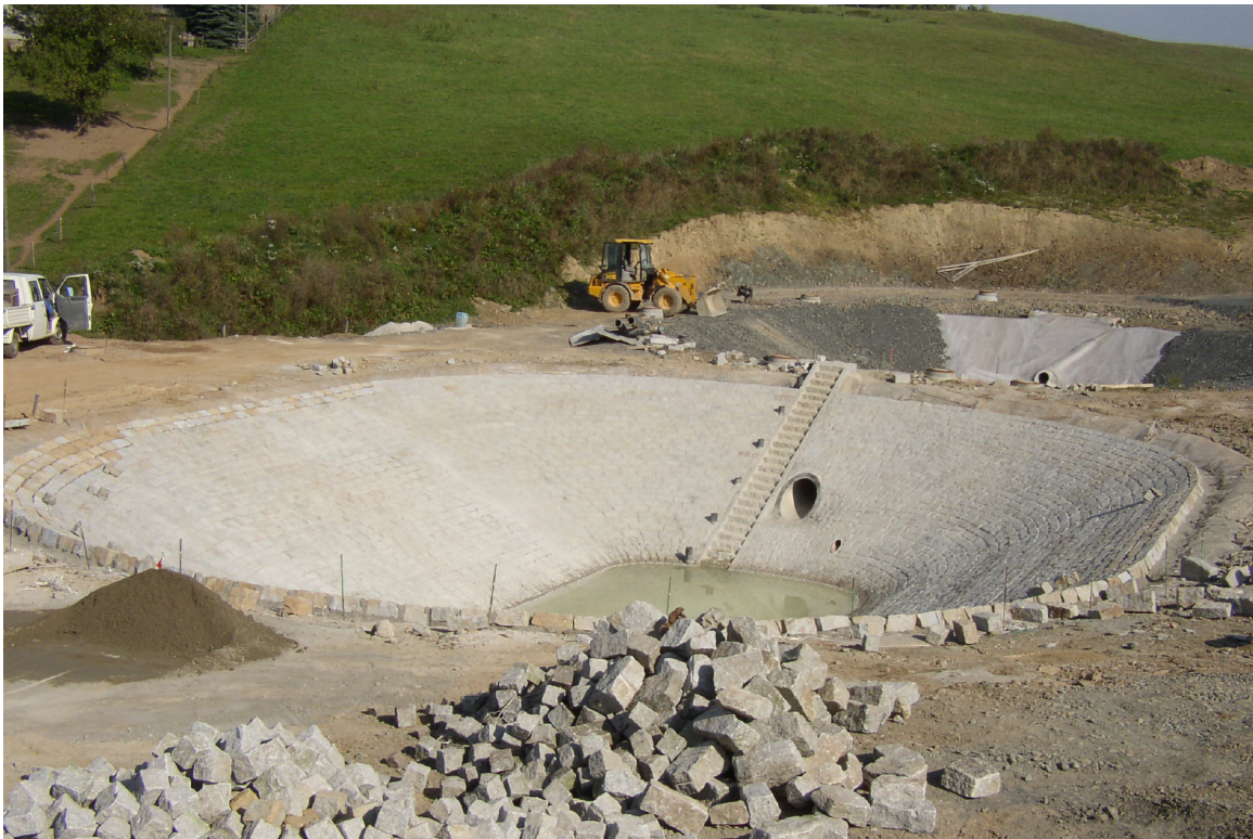
Abb. 65: Technisch ausgestattetes Regenrückhaltebecken [4]
